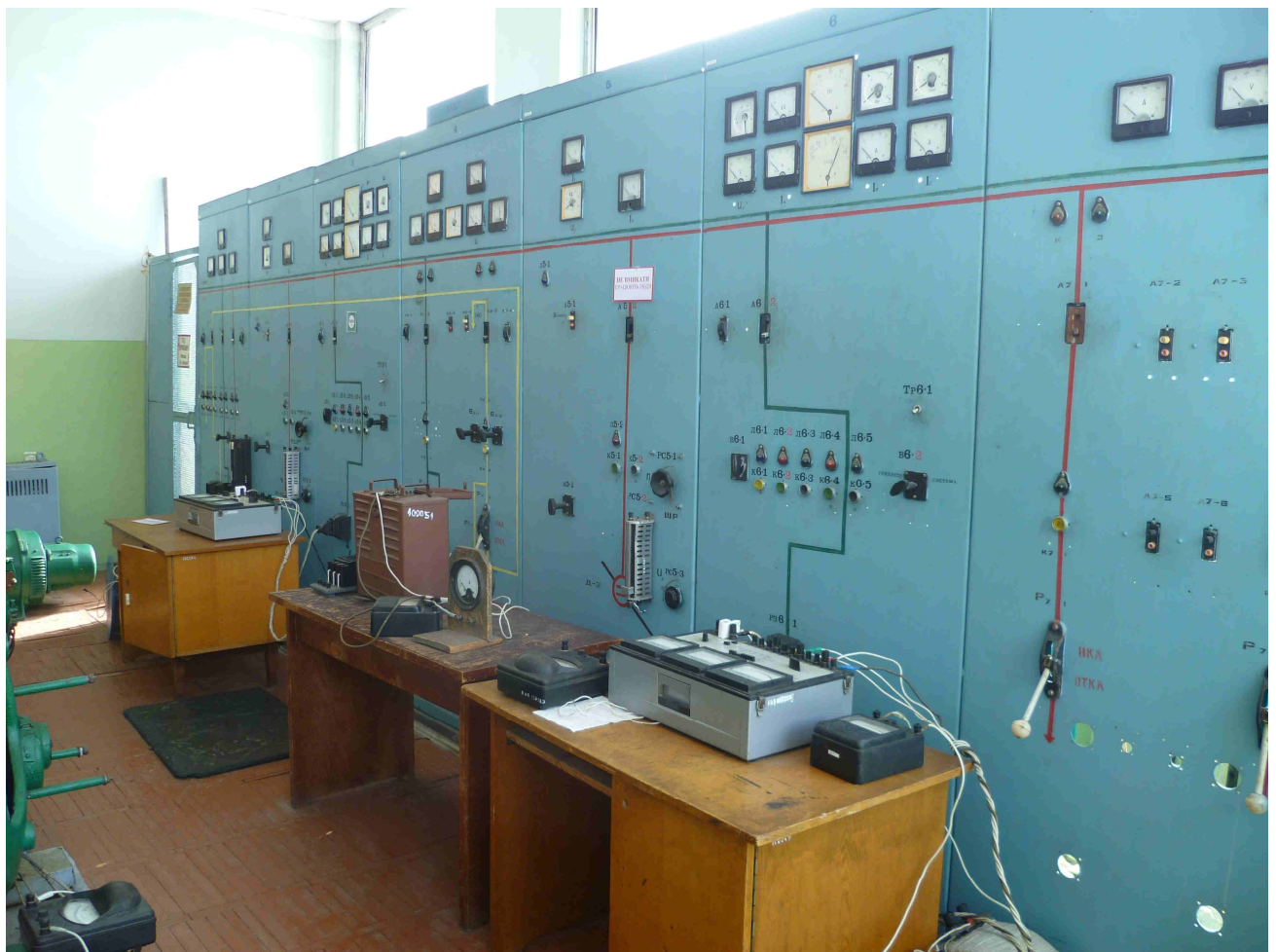
Рис.3. Зовнішній вигляд щита керування 1ЩУ з вимірювальними пристроями
