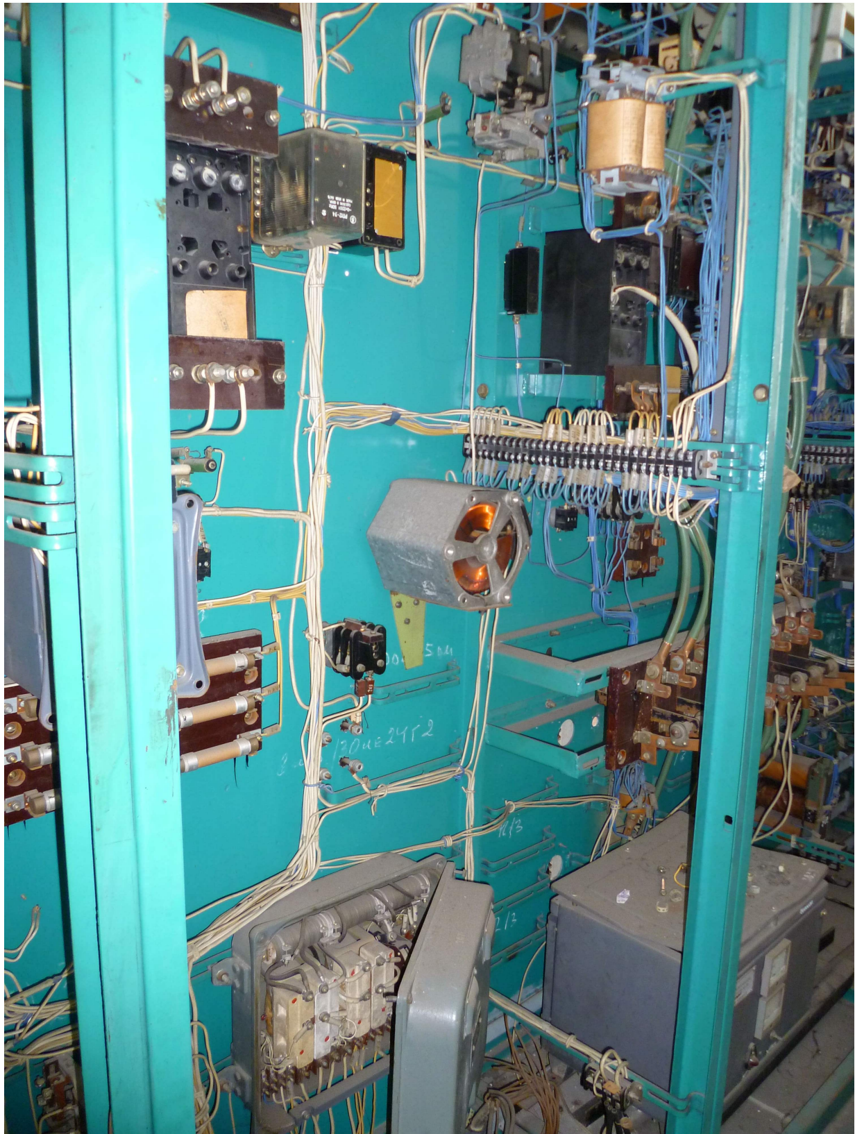
Рис.6. Зовнішній вигляд ланцюгів живлення, сигналізації та керування щитом 2ЩУ
