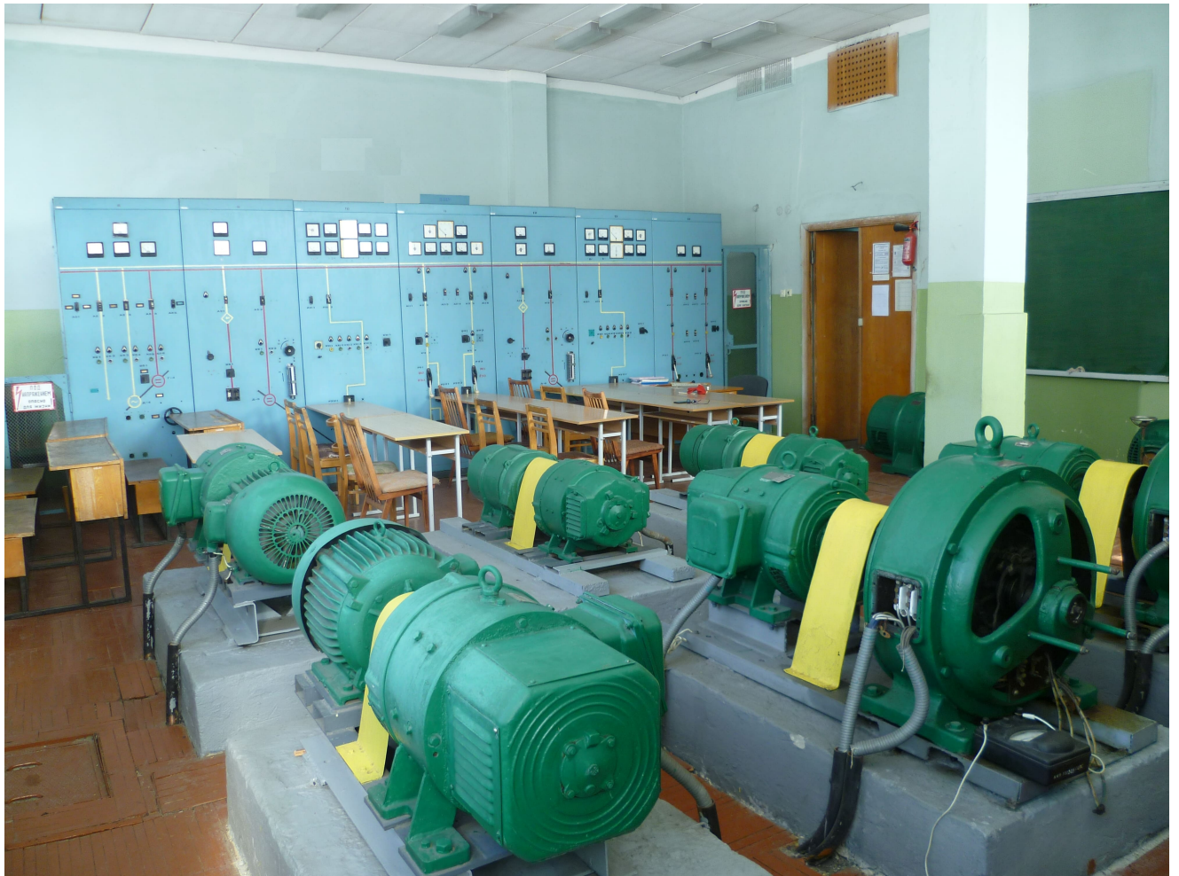
Рис.4. Зовнішній вигляд щита керування 2ЩУ з синхронними генераторами та двигунами постійного струму
